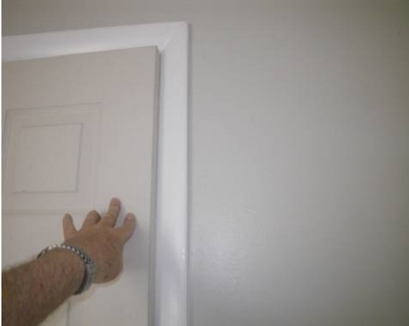
Door binds on top unit.
